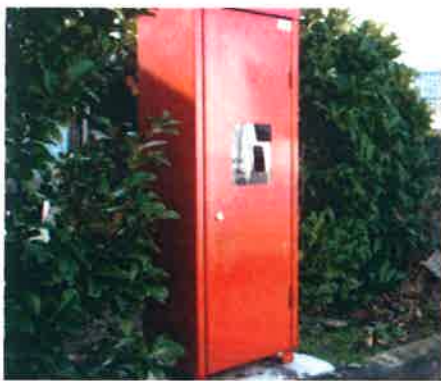
Photo 1 : coffret commande manuelle
